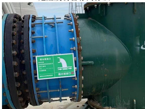
DW001 雨水排放口
