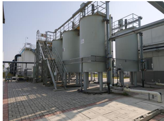
工业废水处理设施
