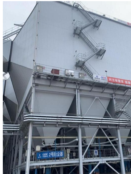
静电除尘设施
