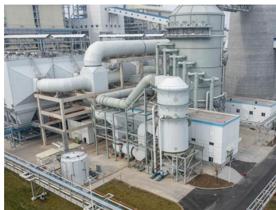
脱硫废水深度处理设施
