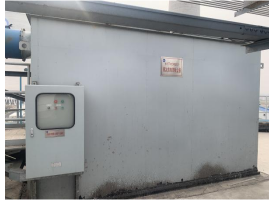
原灰库库顶除尘器
