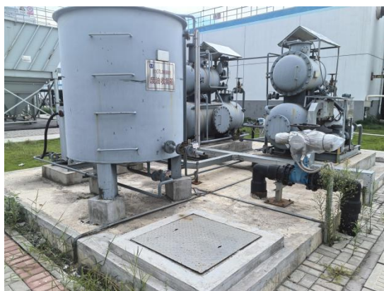
含油废水处理设施
