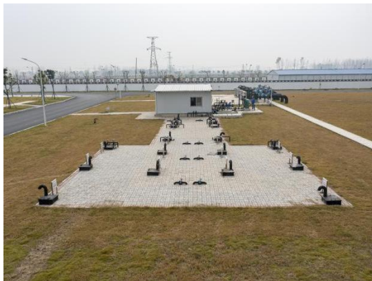
生活污水处理设施
