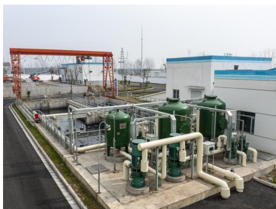
含煤废水处理设施
